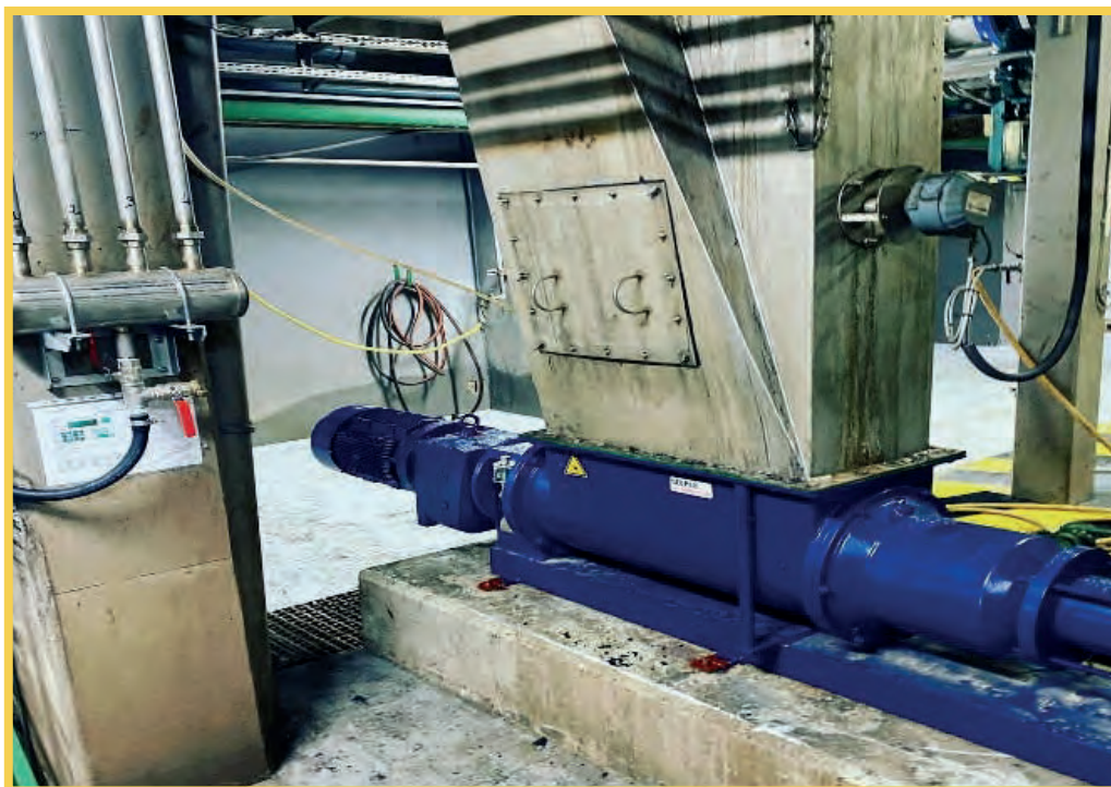
Pompe à boues sur la station d'épuration de la mairie de Martigues
